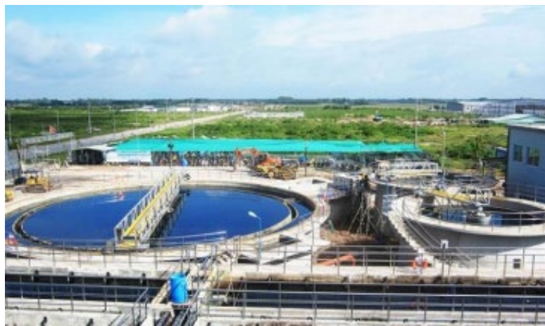
Hình 4: Nhà máy nước sạch KCN Phước Đông
