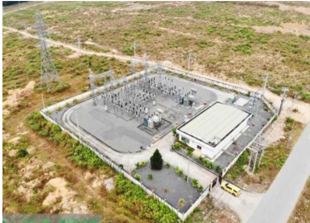
Hình 3: Trạm biến áp KCN Phước Đông
